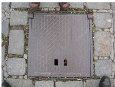
Kanaldeckel 1928 der Österr. Arsenalwerke Quelle: schlot.at - Industrie-Dokumentation (www.schlot.at)
